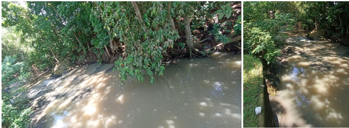
Gambar 2. Kondisi Eksisting Dinding Penahan Tanah di Area sungai Pura Pekendungan
